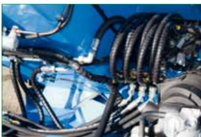
Kein Durchscheuern der Hydraulikschläuche durch über Schottplatten geführte Hydraulikleitungen
